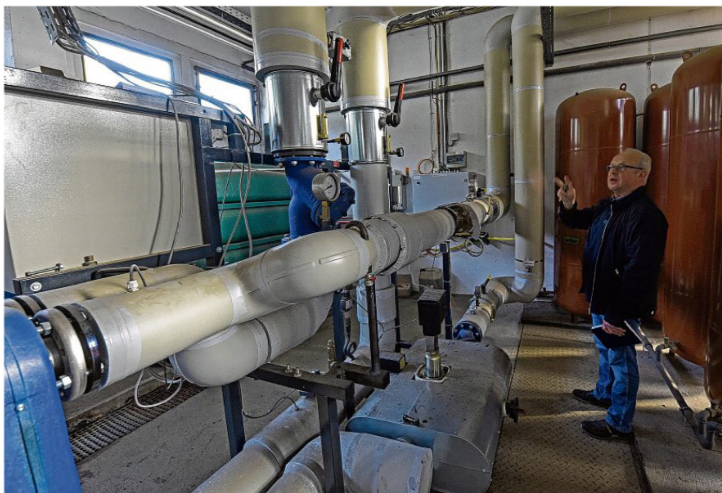
Energiemanager Bernhard Wahle zeigt die Anlage, wo das Biogas ankommt. Viel Platz braucht die nicht mehr.
